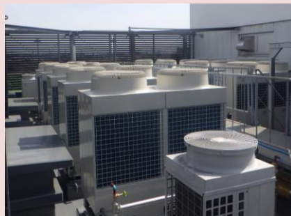
加熱専用の空冷ヒートポンプチラー
