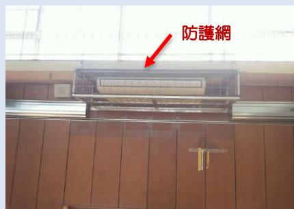
体育館内 室内機の様子
