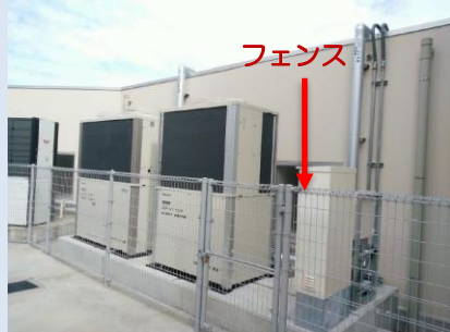
左近山屋上 室外機の様子
