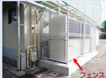
鶴ヶ峰小体育館裏 室外機の様子
