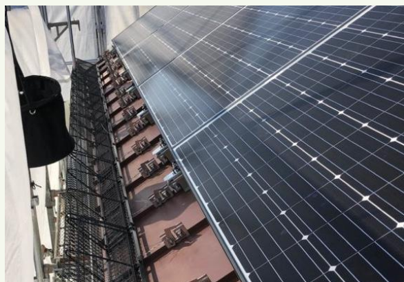
写真：太陽光パネルからの落雪防止処置の例（画像左側）
