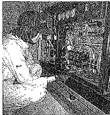
空調設備の点検や修理に取り組む女性技術者
